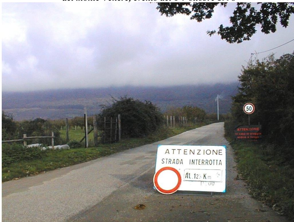
Accumulo di fango e danni provocati alla strada provinciale Lago di Vico, ai piedi del monte Venere, evento del 6-7 ottobre 1998
