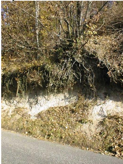
Fig. 7.6: Segni del deflusso in bosco che emerge per opera della soluzione di continuità del pendio indotta dalla costruzione della strada.
